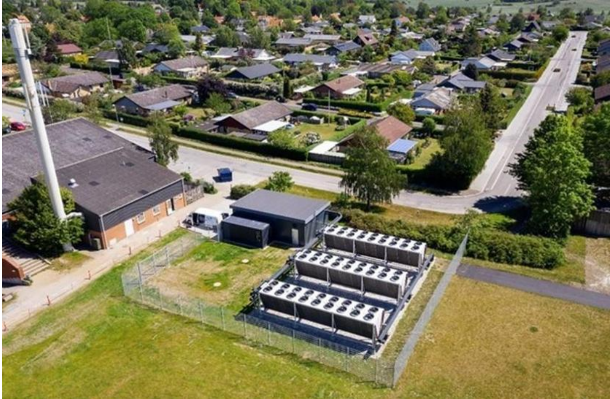
Abbildung 27: 1, 2 MW Luft-Wärmepumpe in Slagslund Dänemark (Quelle: PlanEnergi)
