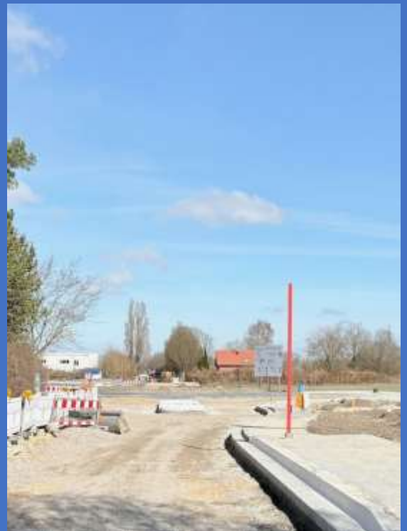
Die Bushaltestellen des öffentlichen Nahverkehrs wurden bereits auf beiden Seiten des Kreisels an der Tangstedter Chaussee angelegt.
